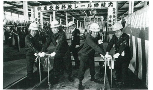
宮城県と結ばれた東北新幹線のレール。ひかり号が盛岡まで来るのももうすぐ(盛岡駅)
