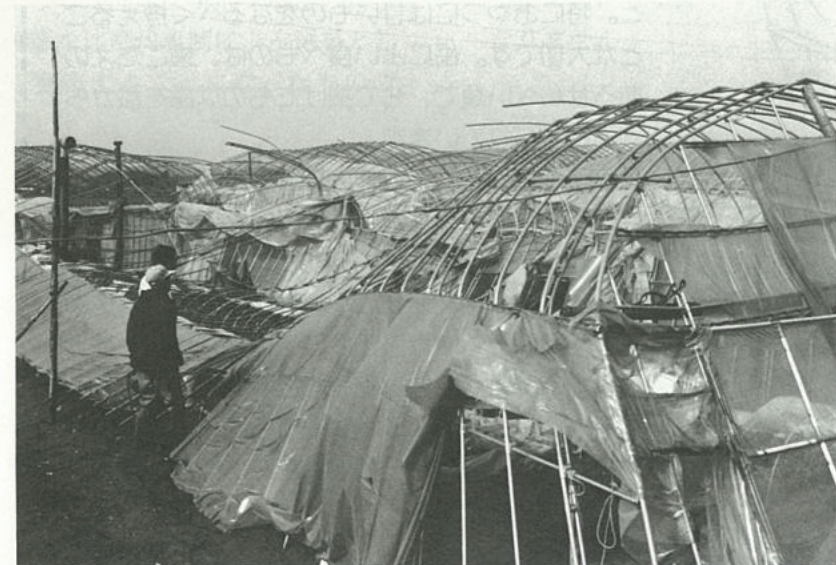
▲ 折からの強風で崩壊したパイプハウス (松尾村)
