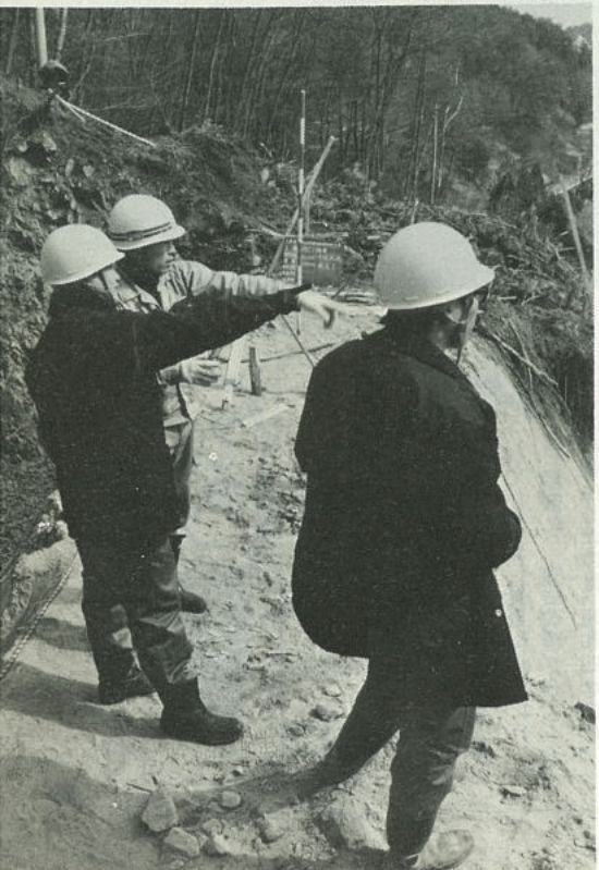
進行状況をチェック。現場との打ち合わせは、工事を進めるうえで最も重要だ。
